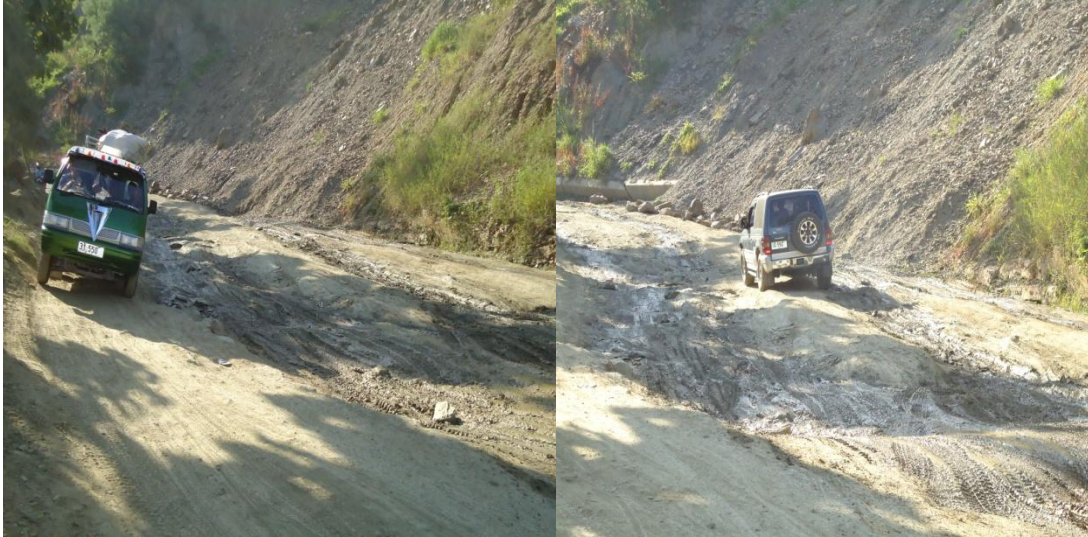
Figura 4.2 - Problemas de drenagens e erosões que afectam qualidade das estradas.
